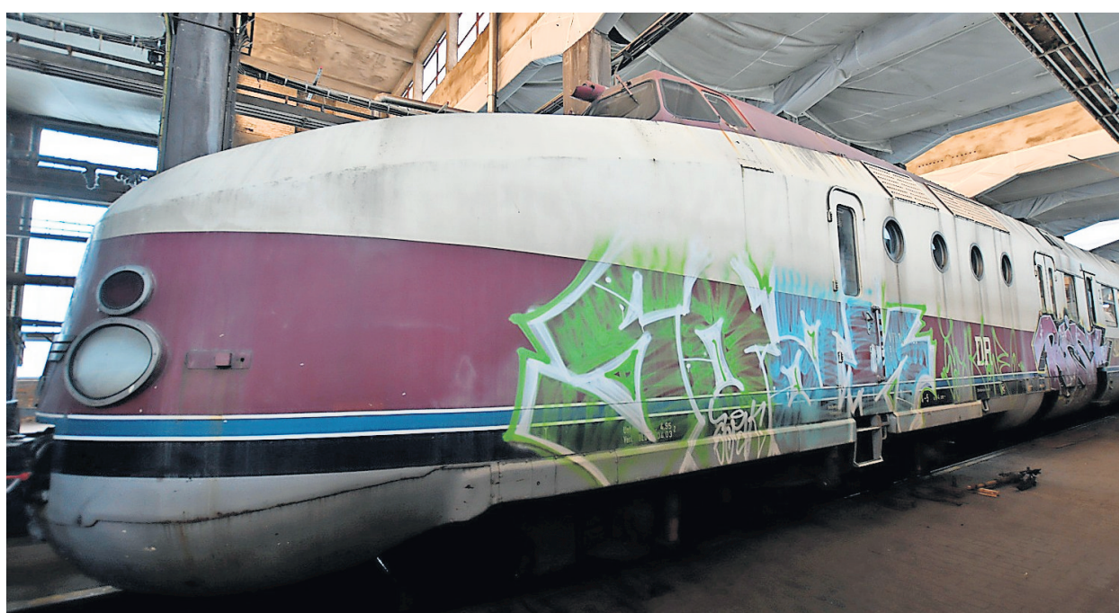
Witterung und Schmierfinken haben den Zug über die Jahre zugesetzt. An einigen Stellen hat der Rost sogar schon kleine Löcher in die stählerne Hülle genagt.
